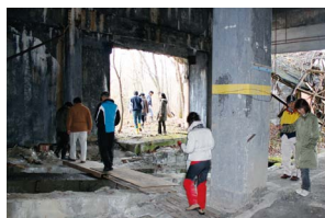
運搬立坑1階坑口。崩壊した建物内に支柱のみが剥き出しで目立つ
